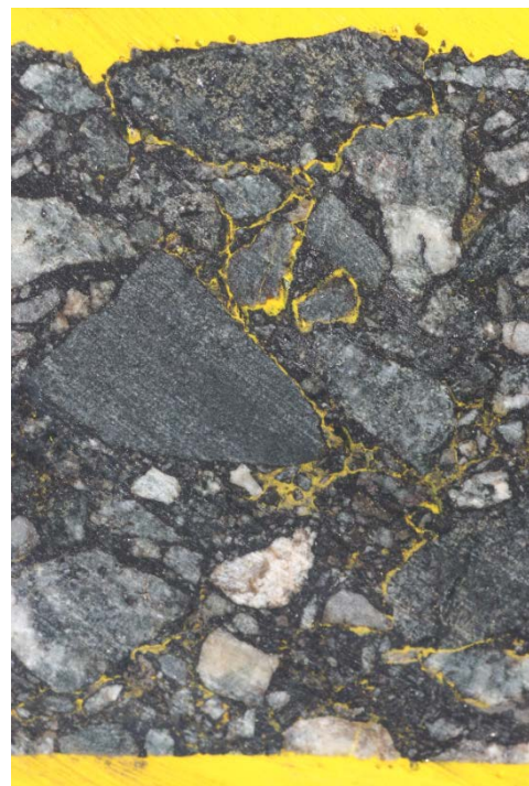
Abb. 14: BK14 L2 V – Es gibt viele feine Risse, deren Ursprung oben liegt, aber auch im mittleren Bereich des Bildes ist die inhomogene Gesteinsmatrix durchgerissen.
