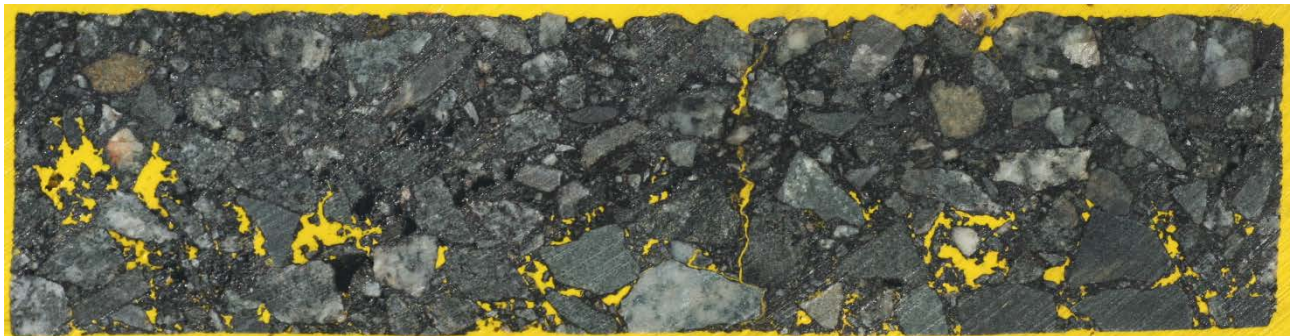
Abb. 6: Bohrkern 9 (BK9) Lamelle 1 (L1) Rückseite (R) – Es gibt einen Riss von oben bis unten und viele Hohlräume im unteren Teil der Asphaltdeckschicht, dessen Material sehr inhomogen ist. Es ist beim Betrachten dieses Foto nur schwer vorstellbar, dass das Mischgut aus nur einem Gestein besteht.
