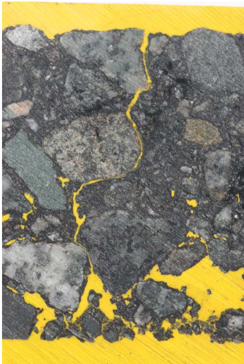
Abb. 13: D BK9 L6 V – Der Riss durchtrennt alle Elemente des Asphaltes. Der Hohlraumgehalt im unteren Teil des Asphaltes ist groß. Die Inhomogenität erheblich.
