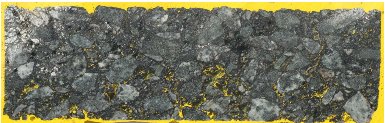
Abb. 10: BK14 L6 R – Im rechten Bildteil ist ein Riss, der von oben beginnt und sich nach unten verzweigt. Es gibt viele Hohlräume in den vielzähligen inhomogenen Bereichen.
