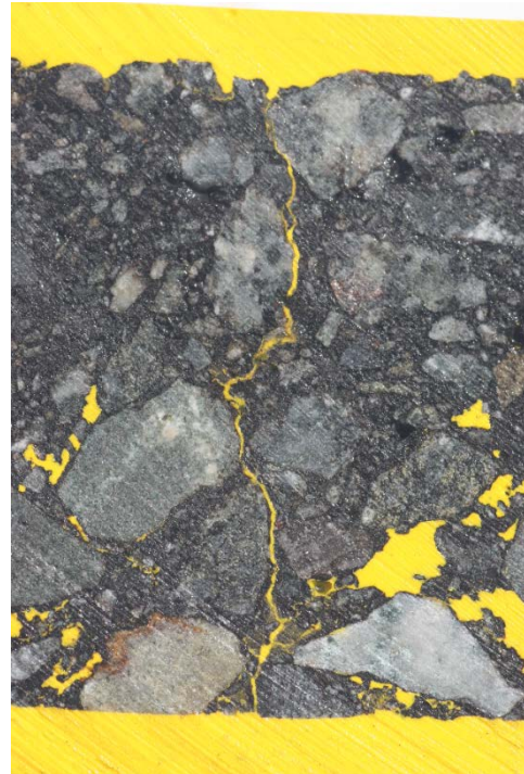
Abb. 12: D BK9 L5 V – Der Riss durchtrennt die einzelnen Komponenten des Asphaltes. Die Inhomogenität ist erheblich, der Hohlraum im unteren Teil ebenfalls.
