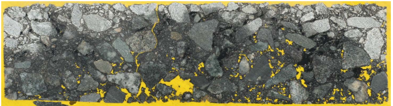
Abb. 7: BK9 L6 V – Der durchgehende Riss führt direkt am Gesteinskorn vorbei, läuft durch den Mörtel, wieder an einem Gesteinskorn vorbei, wieder durch den Mörtel und zwischen zwei direkt aneinander liegenden Gesteinskörner hindurch in den vorhandenen Hohlraum. Es scheint im Rissbereich keine Verklebung des Mörtels mit dem Gestein zu geben. In der Umgebung des Risses ist der Asphalt inhomogen. Der Hohlraumreichtum im rechten Teil des Fotos ist beeindruckend. Es gibt viele plattige Gesteinskörner.
