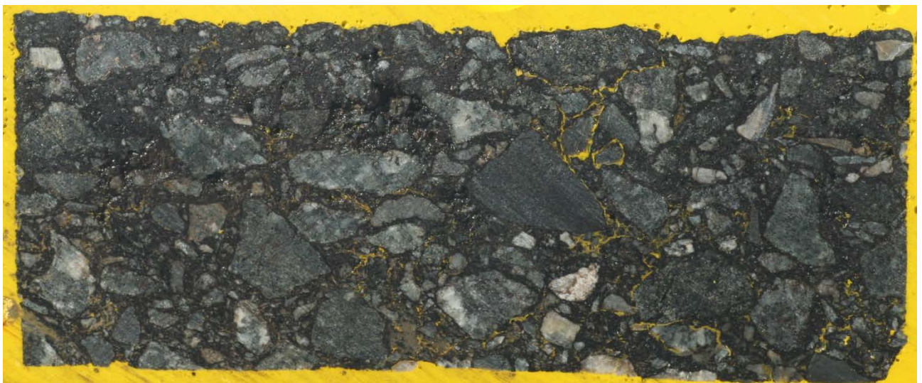
Abb. 9: BK14 L2 Vorderseite (V) – Hier gibt es im rechten Teil des Bildes Risse, die an großen und kleineren Gesteinskörnern entlangführt und auch vor dem Mörtel nicht Halt macht.
